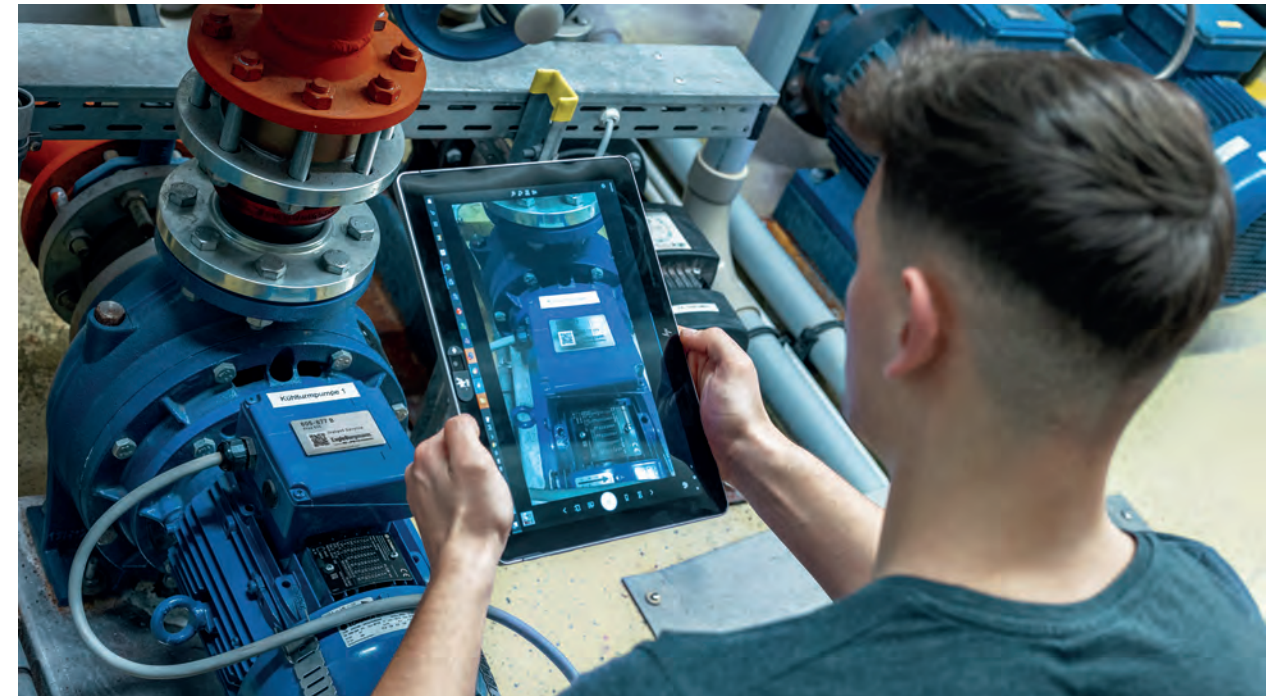
Mit digitalen Lösungen von Freudenberg lassen sich Dichtungen in Pipelines aus der Ferne überwachen.
